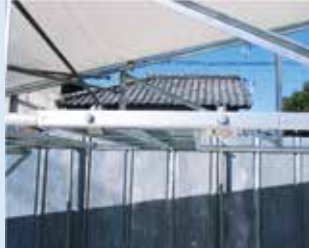
妻側専用レールを、トラス材の下弦材に取付けた状態。(外側)
