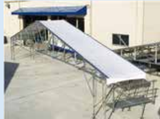
1スパン間に屋根専用シート(2分割用)を設置した状態。また、外側にプラケット設置により、作業場を確保した状態。
